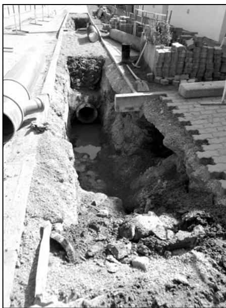
Zborcená dešťová kanalizace.
