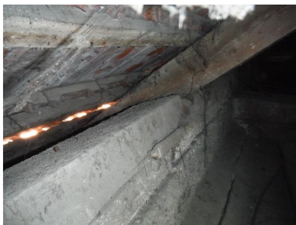
FOTO č. 14: Pohled na místo s vybočením přeplátovaného spoje pozednic, pozednice v místě plátu vybočuje
