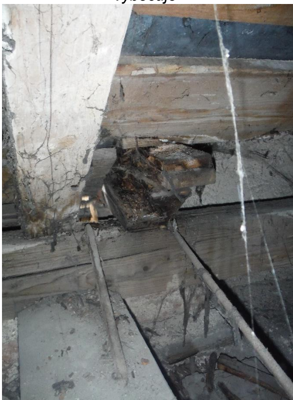
FOTO č. 15: Pohled na námětek v místě zaatikového žlabu, v místě průsaku dešťové vody došlo k rozvoji tlení dřevokaznou houbou (místo D3)
