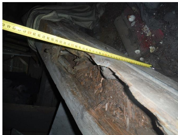
FOTO č. 12: Pohled na další místo s výskytem tlení trámů vynášejícího strop nad sálem 2NP (místo D2)
