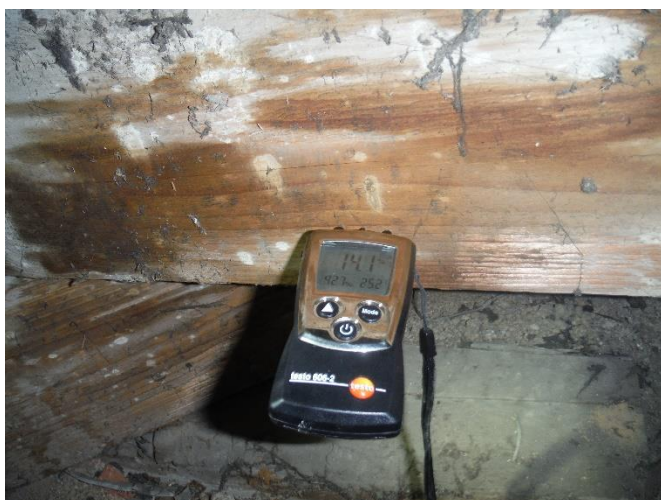
FOTO č. 10: Pohled na lokální místo vykazující projevy zátoků, místo měření vlhkosti prvku
