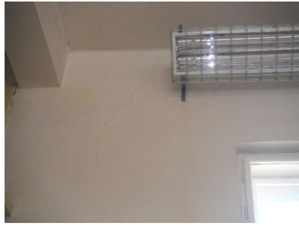
FOTO č. 7: Trhlina v místě obvodové stěny v 1NP (místnost 104)
