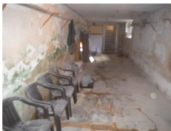
FOTO č. 9: Stav omítek v 1PP v místnosti P105, v koutu místnosti patrná na omítce rhizomorfy houby
