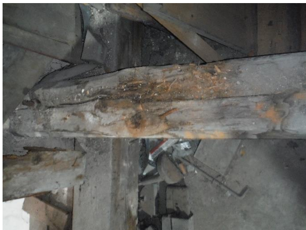
FOTO č. 11: Pohled na místo s výskytem tlení trámů vynášejícího strop nad sálem 2NP (místo D1)
