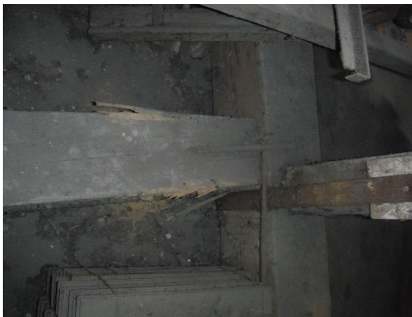
FOTO č. 17: Pohled na poškození trámu dřevokazným hmyzem (místo H1)
