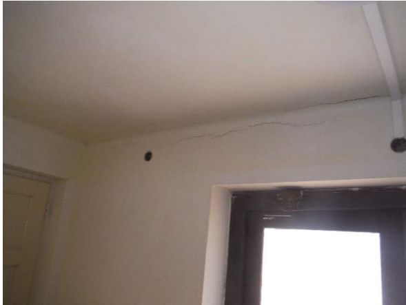
FOTO č. 6: Trhlina v místě obvodové vstupní stěny v 1NP (místnost 101)
