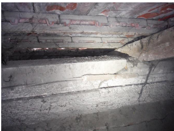
FOTO č. 13: Pohled na místo s vybočením přeplátovaného spoje pozednic, pozednice v místě plátu vybočuje
