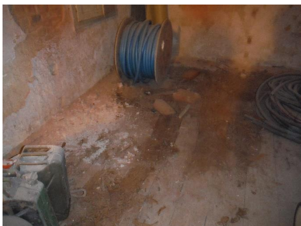
FOTO č. 8: Pohled na odběry vzorků pro stanovení vlhkosti V4, V6 v 1PP; naprosto degradovaná prkenná podlaha
