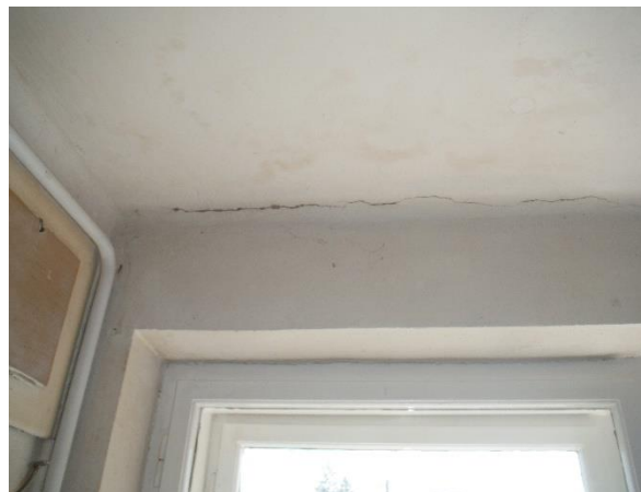
FOTO č. 5: Trhlina v místě obvodové štítové stěny a stropu v 1NP (místnost 102)
