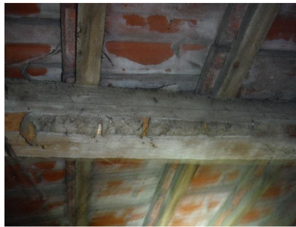
FOTO č. 18: Pohled na neodkorněnou část krokve s výskytem dřevokazného hmyzu (místo H2)
